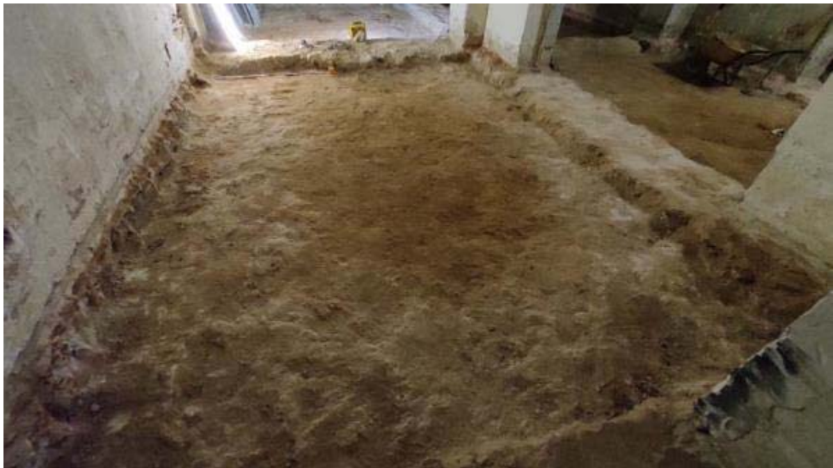
Fotografia 42. Panoràmica final de l'àmbit-19, després d'haver extret els paviments i la solera, i haver rascat el subsol, localitzant les argiles del terreny geològic.
