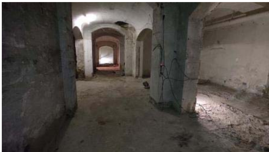
Vista general de la planta-soterrani de l'edifici, a l'inici de la 2a fase. (Foto: Òscar Matas).
