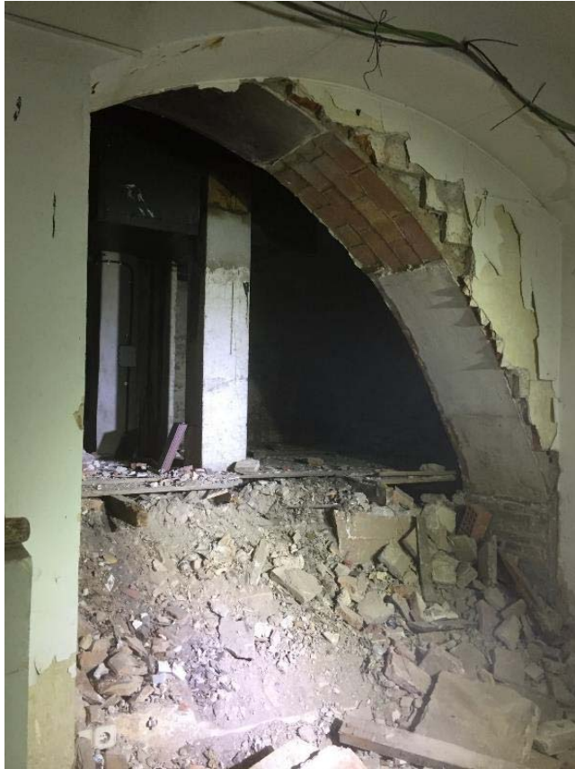
Fotografia 18. Vista interior habitació caixa ascensor amb nivell de runa.
