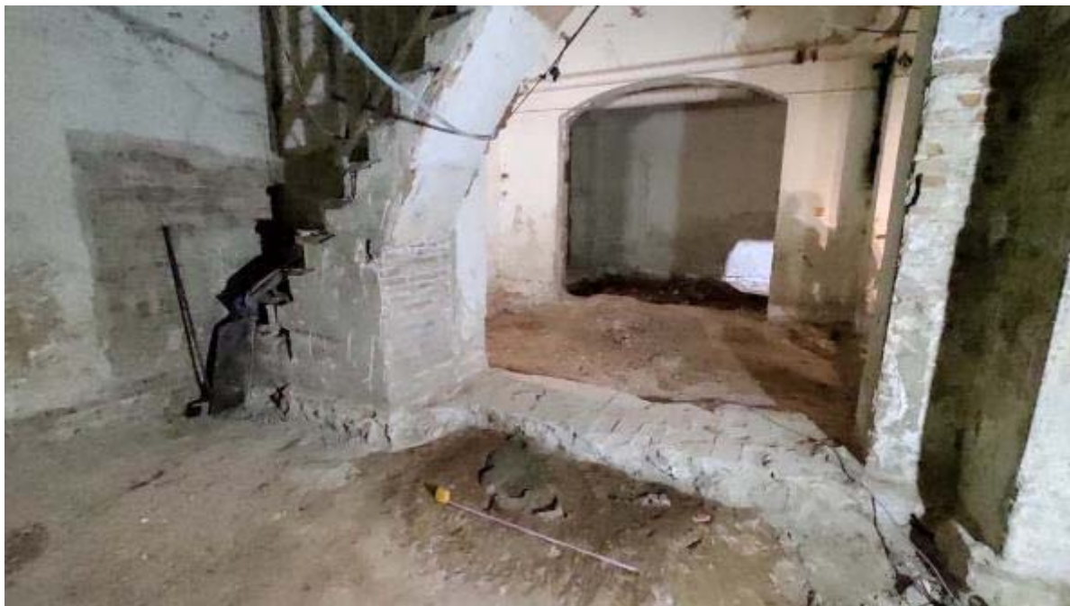
Fotografia 48. Panoràmica de la situació a l'àmbit-17, del pou (UE1007), retallat a les argiles del terreny geològic, des de l'est.
